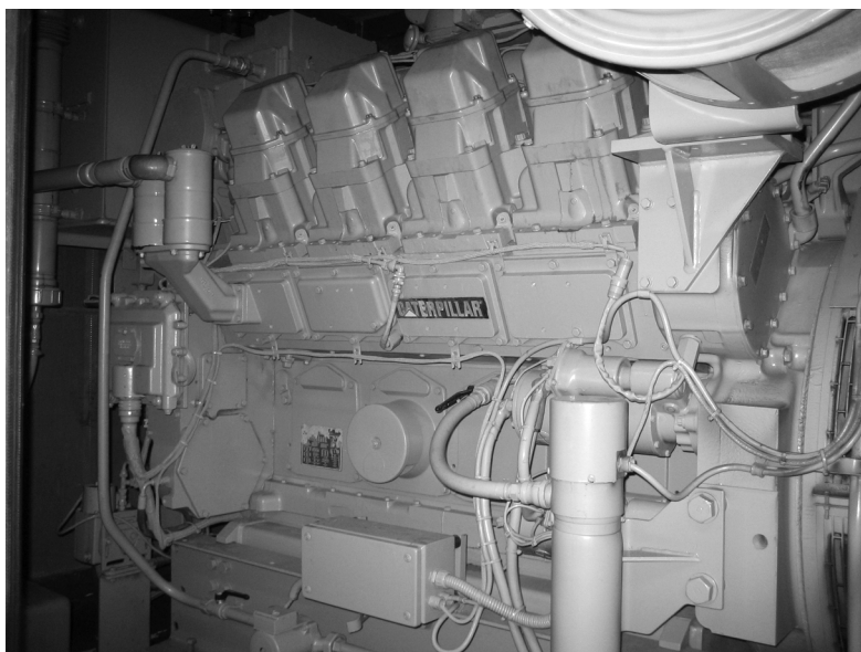
Gasmotoren i varmecentralen, nr. 78
