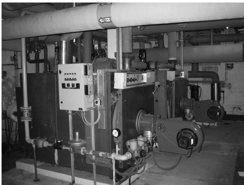
De gasfyrede kedler i varmecentralen, nr. 78
