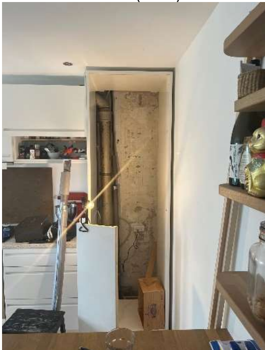
Billede 3 Veksler kan monteres på betonvæg tæt på faldstamme. I skabet er rør til varmt og koldt vand
