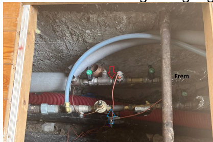
Billede 4 Tilslutning af varm frem lige før trykudligner kold retur lige efter trykudligner. Se
